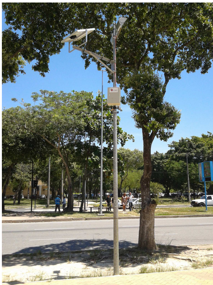
Figura 6.2: Unidade de acostamento instalada na UFRJ.
